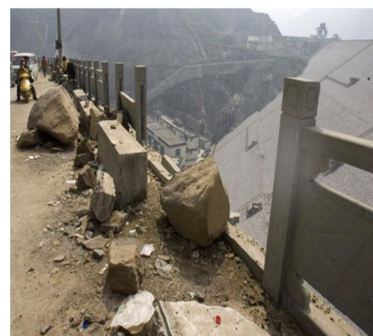
Рис. 7. Фрагменты повреждения плотины «Зипингпу» во время землетрясения в г. Сичуань [7]
