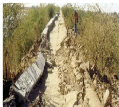
Рис. 6. Продольные трещины на верховой грани плотины Фейтигахдх (Индия), вызванные землетрясением Бхудж 26.01.2001 г. [7]
