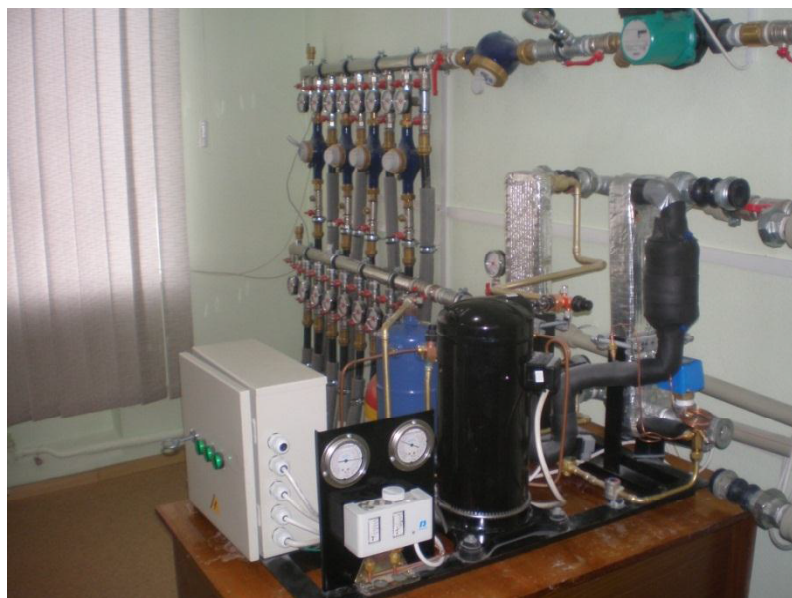
Рис. 1. Наземная часть геотермальной экспериментальной системы УкрГГРИ
