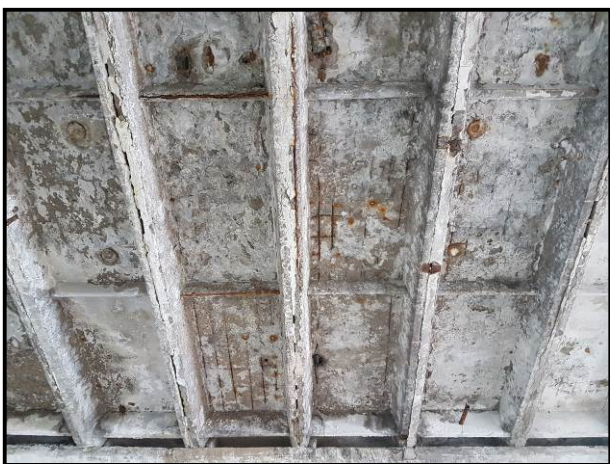
Рис. 3. Следы коррозии плит перекрытия
