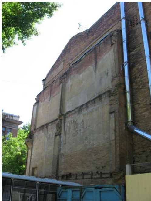
Рис. 9. Руинированные останки здания по ул.Шаумяна между зданиями по ул.Шаумяна, 29 и ул. Шаумяна, 27 (фото автора)
