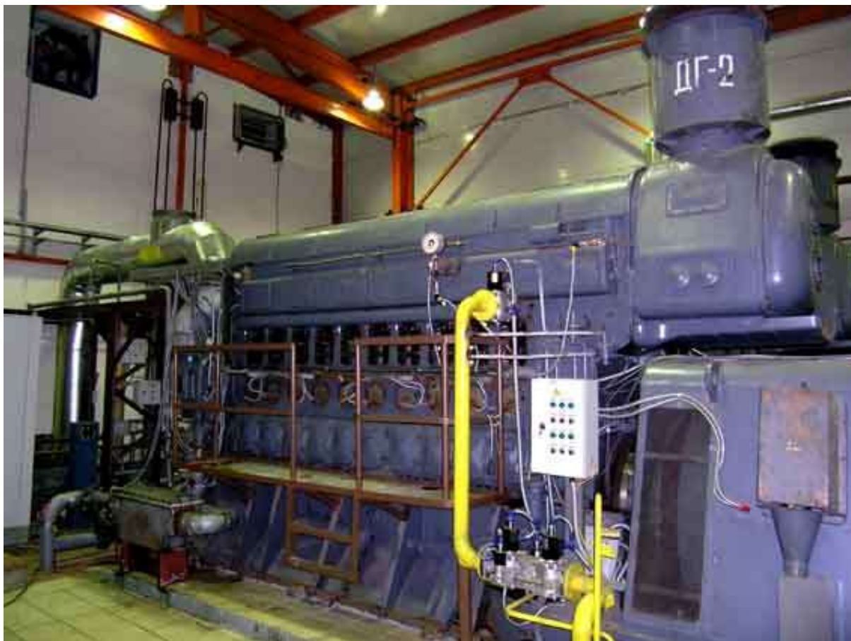
Рис. 9. Газопоршневой мотор-генератор 11ГД100 мощностью 1000 кВт, конвертированный из дизель-генератора 7Д100М
