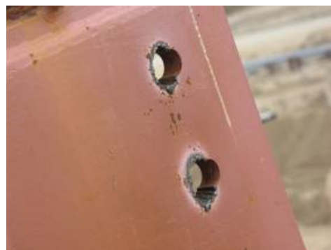
Рис. 8. Увеличение диаметров отверстий опорных пластин (послеаварийное состояние)
