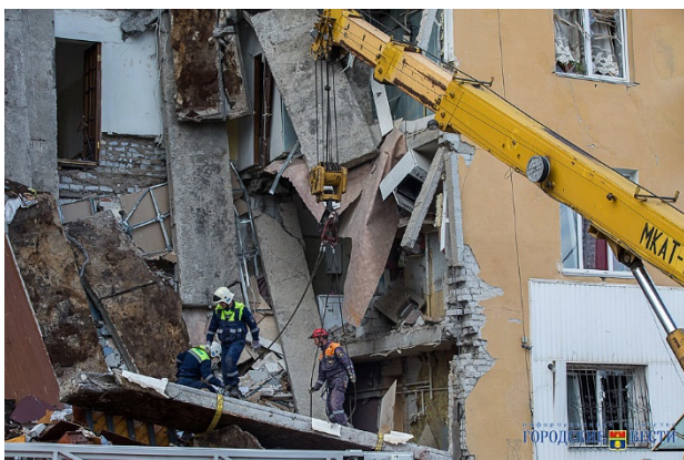
Рис. 6. Условия реконструкции, ремонта и ликвидации завалов
